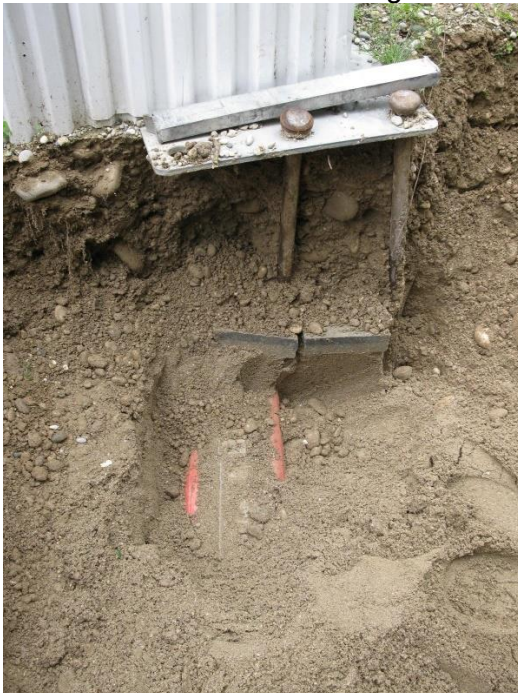
Kabelschaden verursacht durch Erdnagel
